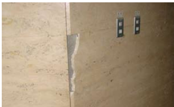
● 大理石の壁が破損
