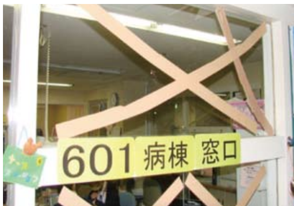
● ナースステーションのガラス破損
