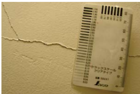
● 壁のクラック
