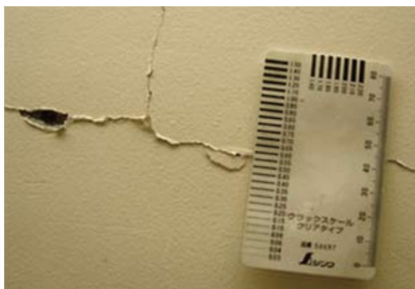
● 壁のクラック
