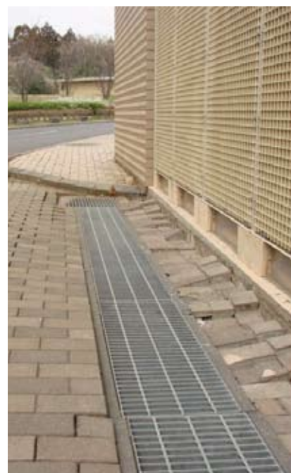
● U字溝沈下、グレーチング沈下
