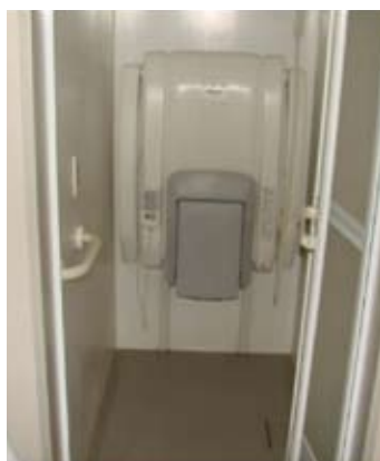
● シャワー室給水・排水不良
