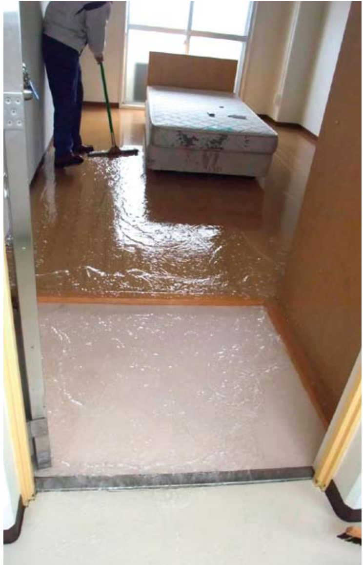
漏水で水があふれた看護師宿舎4号棟
