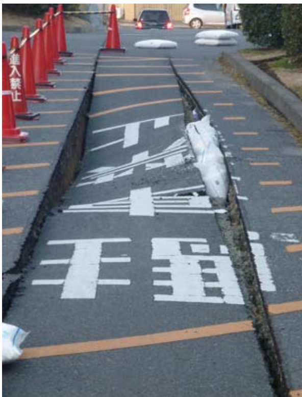
陥没した道路
