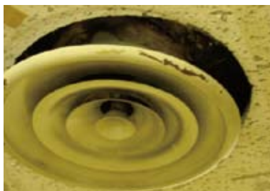
● 天井の吹出口が外れる
