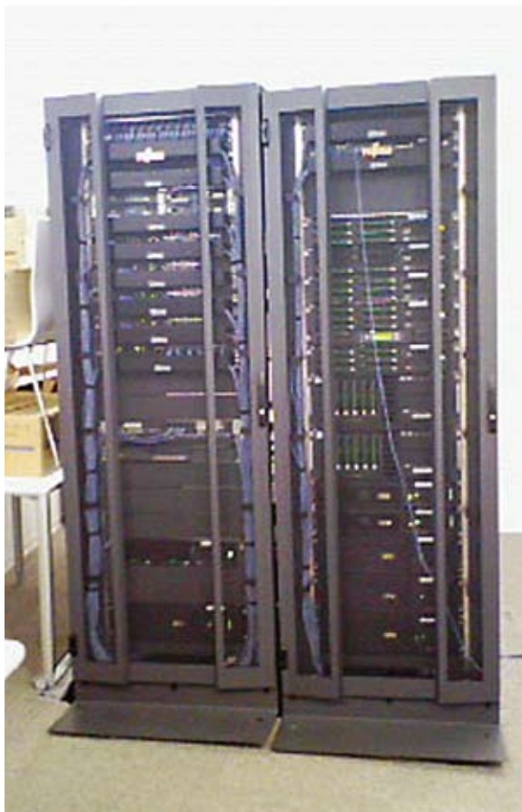
i-Labのサーバーが傾き、オンラインシステムが一時停止した
