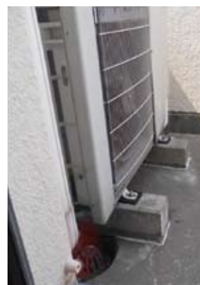
● 室外機がずれた
