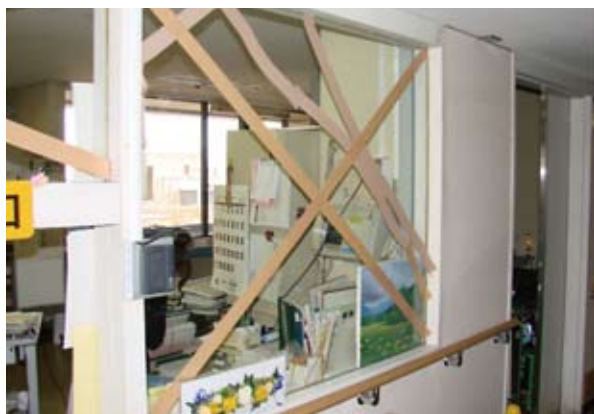
● ナースステーションのガラス破損
