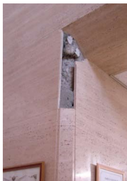
外来ホール柱の大理石が破損
