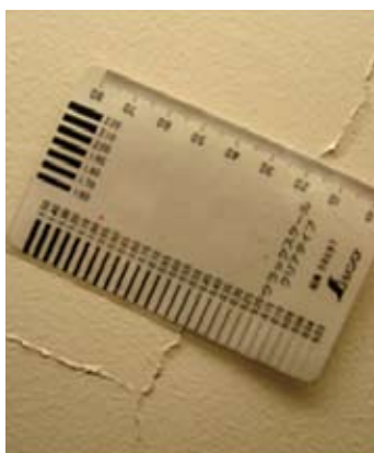
● 壁のクラック
