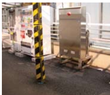
● 外来入口のアスファルトが沈下
