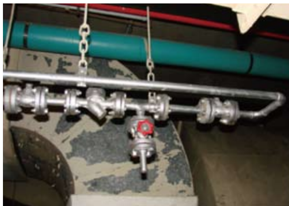
●空調設備の破損
