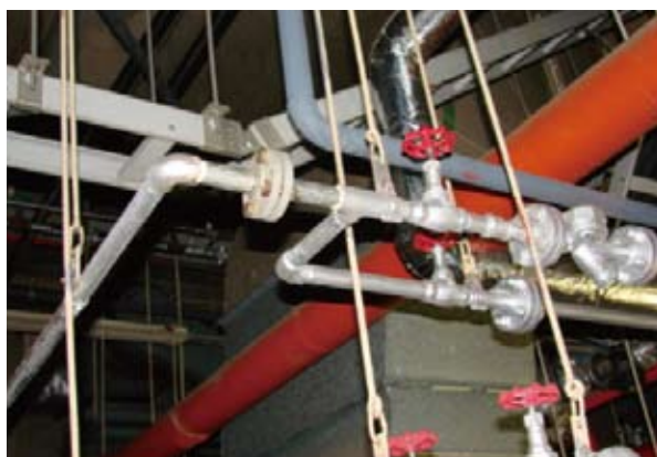
● 空調設備蒸気破損
