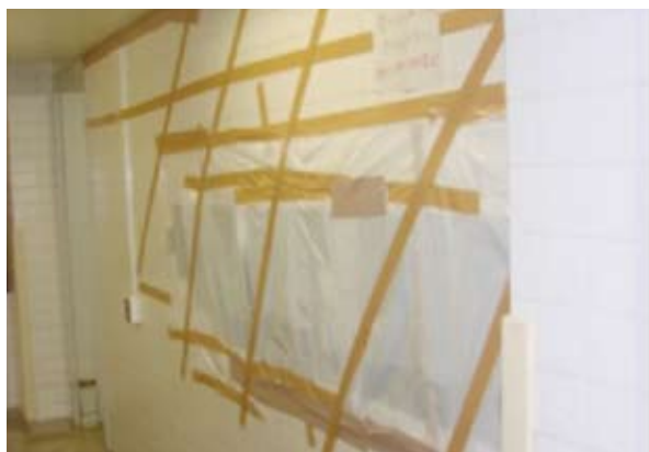
●病棟トイレのタイルが落下
