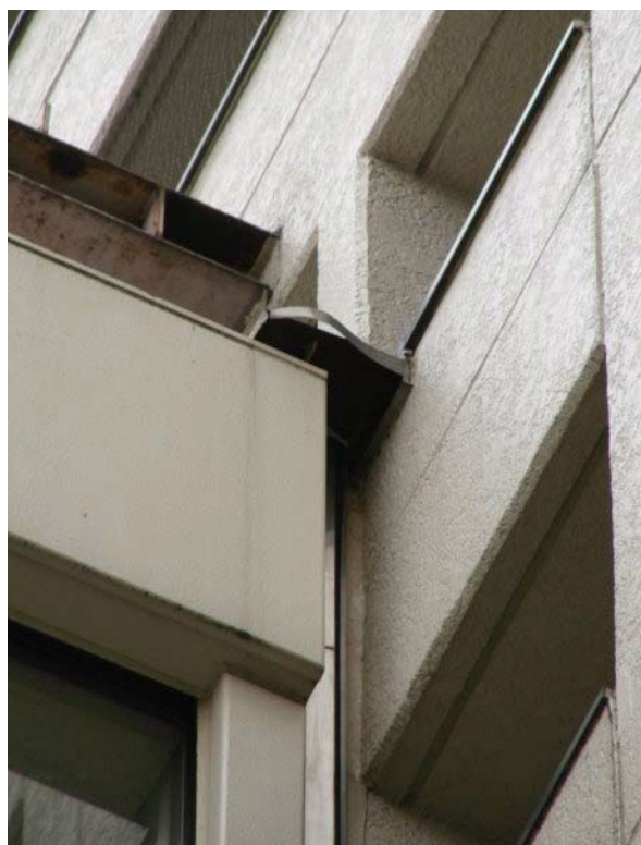
● 外部エクspansionジョイント部の破損
