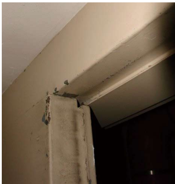
● 鋼製扉破損 ● クラック
