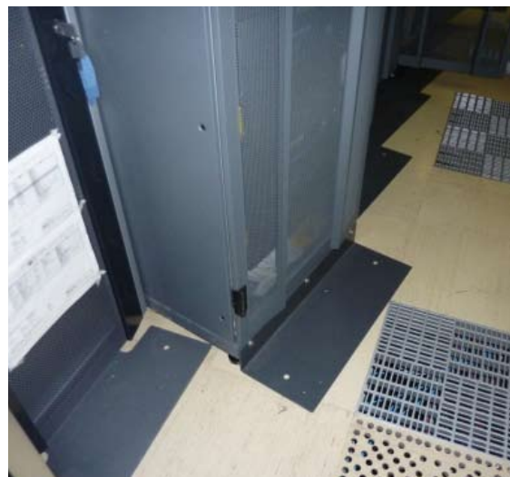
電算機室内のサーバラックの様子（幸い倒れなかったものの、全体にねじれるようにずれた）
