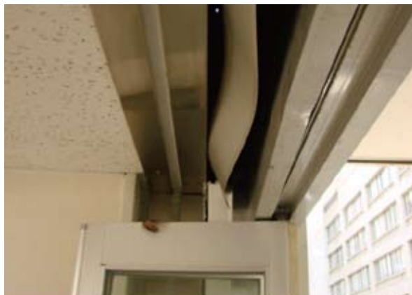
●内部エキスパンションジョイント部の破損
