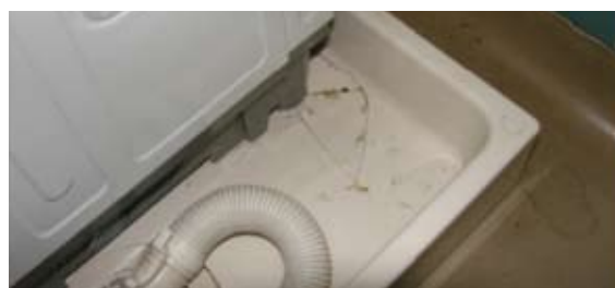
● 洗濯機パン破損
