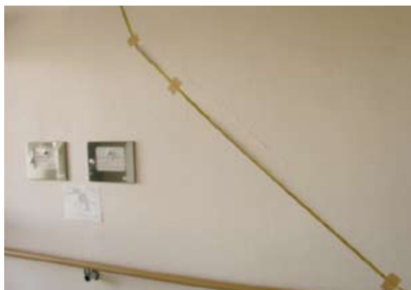
● 廊下壁のクラック
