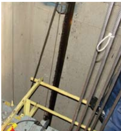
●ビット内エレベーターロープが引っかかる
