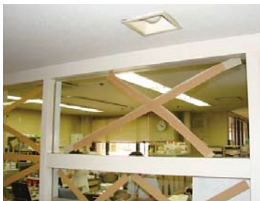
● ナースステーションのガラス破損
