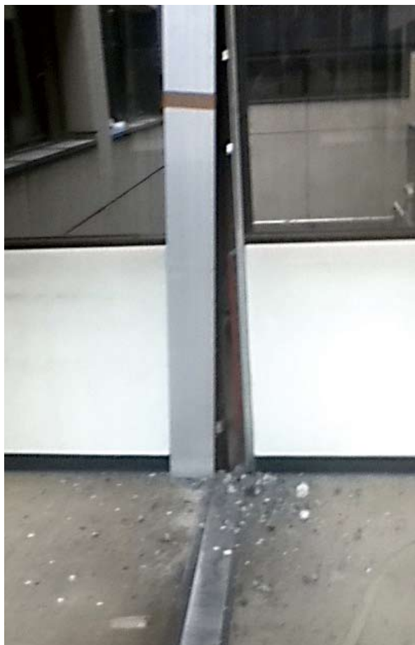
● 薬剤部前渡り廊下のエキスパンションジョイント破損
