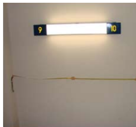
● 階段室壁のクラック
