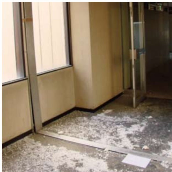
● 内部エクspansionジョイント部の破損
