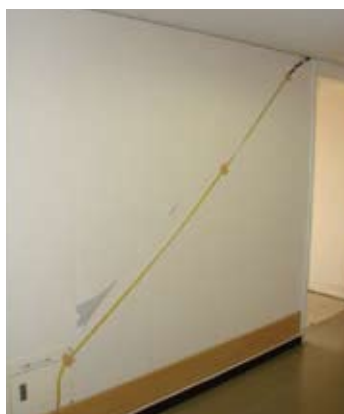
● 廊下壁のクラック
