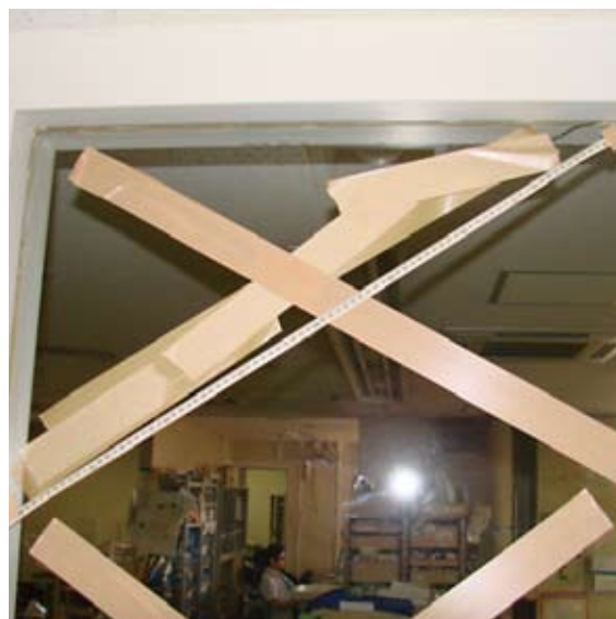
● ナースステーションのガラス破損
