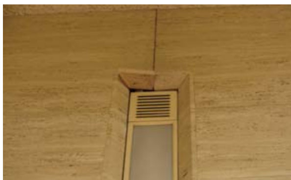
● 吹き抜け部大理石の壁が破損
