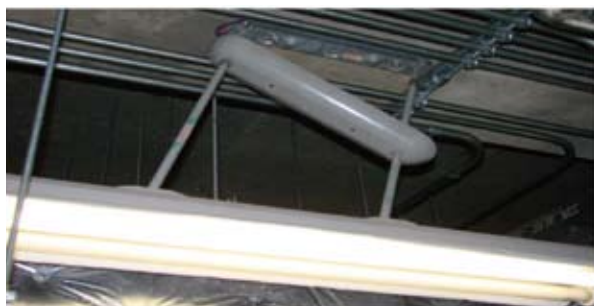
●照明器具の破損
