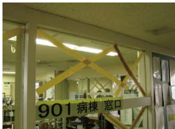
● ナースステーションのガラス破損
