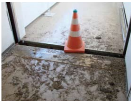
● 内部エキスパンションジョイント部の破損
