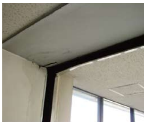
● 内部エキスパンションジョイント部の破損
