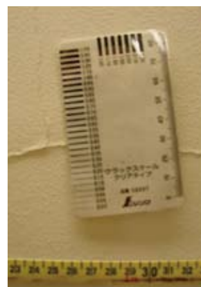
● 壁のクラック
